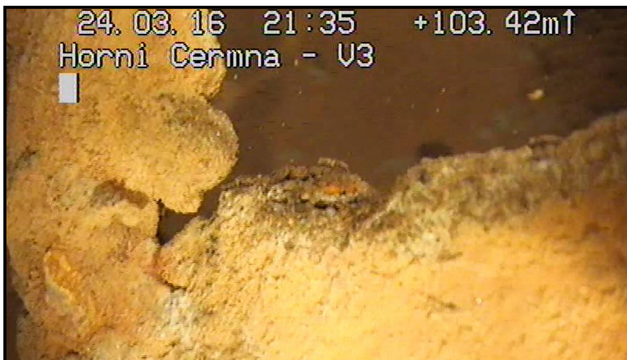
Obr. č. 2: Zkorodovaná svrchní část perforované výstroje \varnothing 190 mm – 103,42 m.
