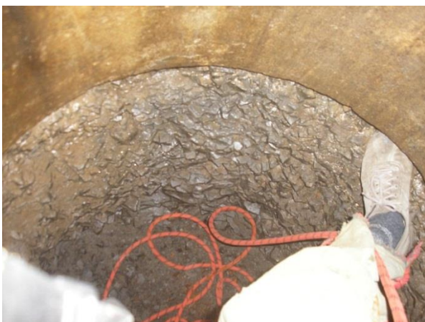
Foto 1: Pokles hladiny vody ve studni vlivem vrtu s hydraulickým zkratem (lokality Obruby, ve studni je normálně 4 m vody).
