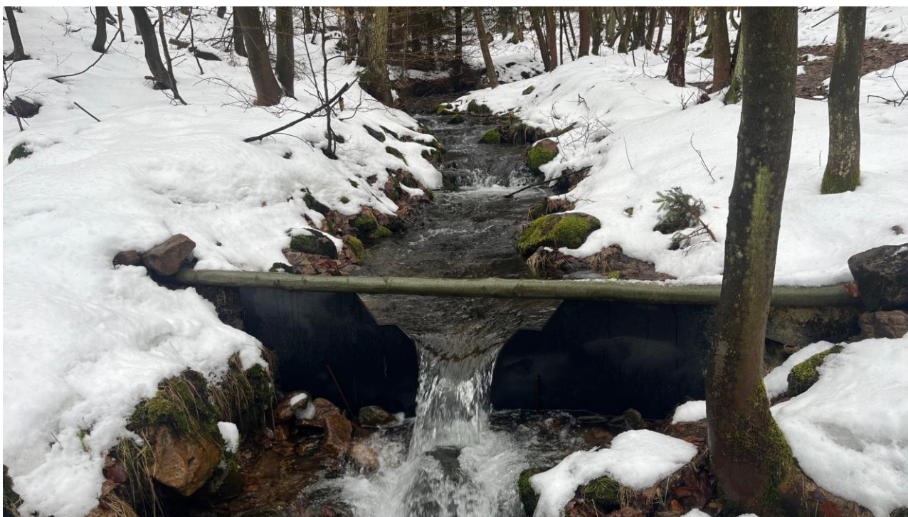
Obrázek č. 9 Složený Cipolettiho a Thomsonův měrný přeliv s automatickým záznamem průtoků
